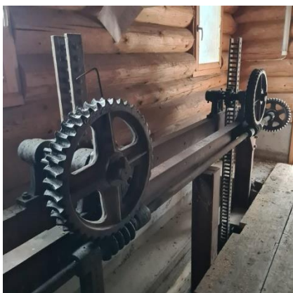
Bild 6: Kolmatierungsanlage, um den Wasserzufluss in den Amphibienhabitaten in Maienfeld zu kontrollieren.
